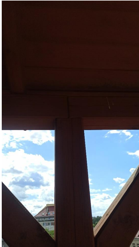
Rys. 4 Widok połączenia płatwii – konieczność zastosowania łączników ciesielskich
